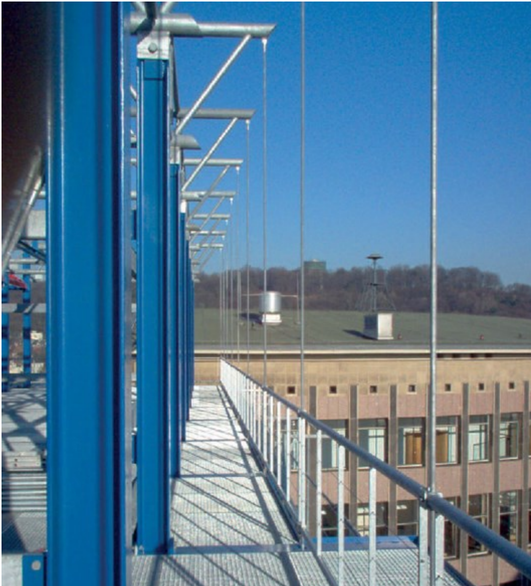
Abbildung 8: Stahlkonstruktion, Korrosionsschutz als Duplex-System
