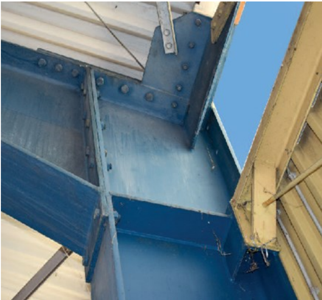
Abbildung 15: Fotos einer Inspektion der Beschichtung der Kunsteisbahn Balingen nach 41 Jahren.
